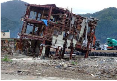
傾いた鉄骨建物
