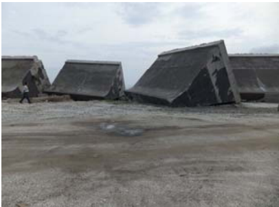
押し倒された防潮堤
